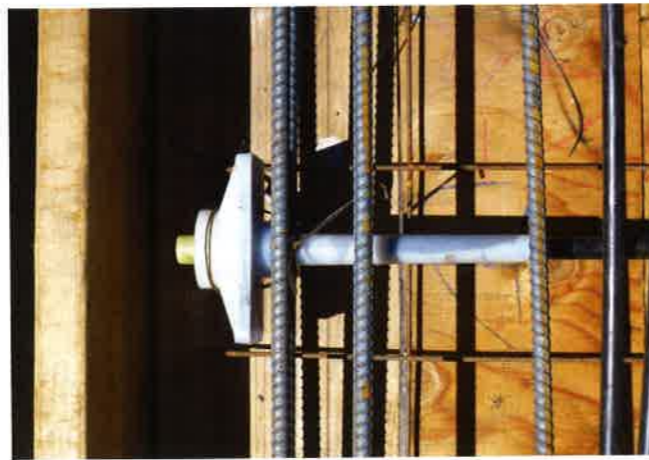
(d) Dead end, corrosive (P153d)
